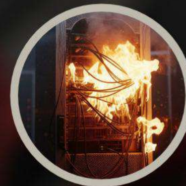
телекоммуникационное оборудование и ЦОД
